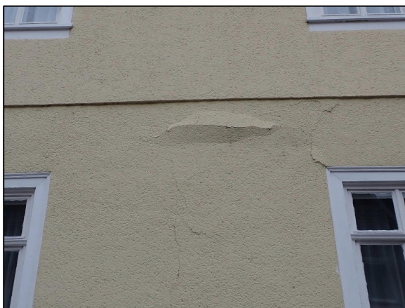
Abbildung 22: Schäden am Außenputz
