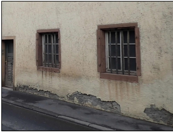
Abbildung 24: Schäden am Verputz im Sockelbereich und Verfärbung der Fassade
